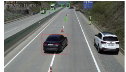
공사 구역 차량 침범 검지
