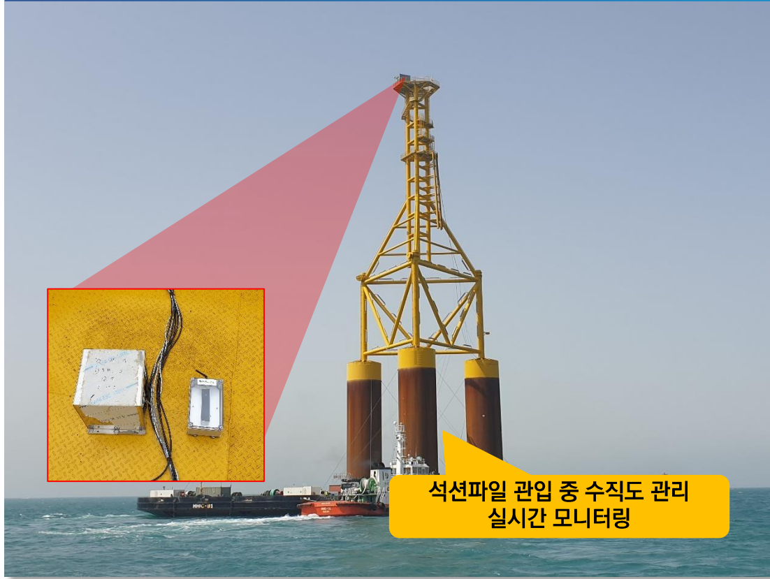
해상풍력발전기 설치 공사 중 지지구조물 실시간 모니터링
