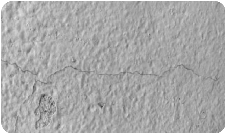
건물 균열 데이터
