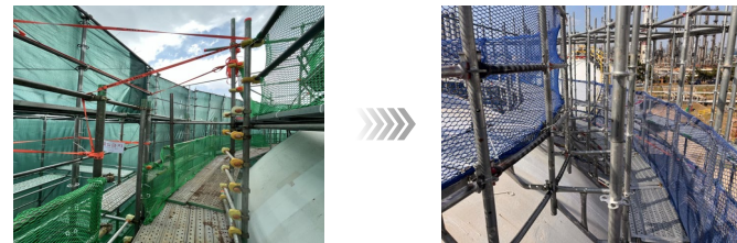
보행로 간섭 발생 부딪힘의 원인 비계파이프 시공시 끝부분 마감부위 등
