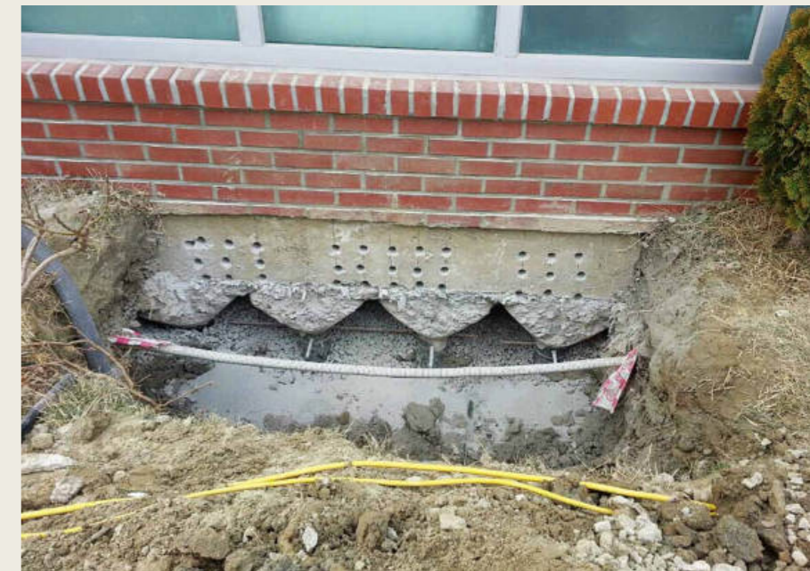
시공 후 | 연약지반에 팽이기초로 보강되었으나 자중 증가로 침하 촉진
